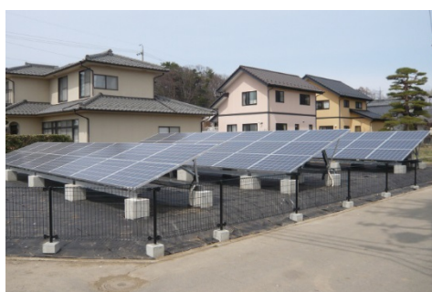
写真 2-4 低圧案件 地上設置
