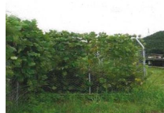
草木の成長によるフェンスの 倒壊事例-1
