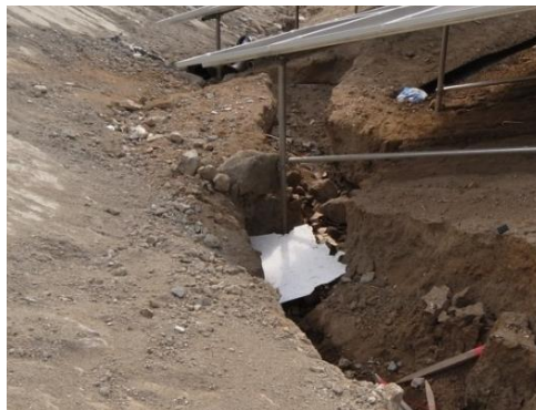
地割れの事例
