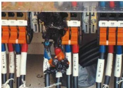
端子台の焼損
