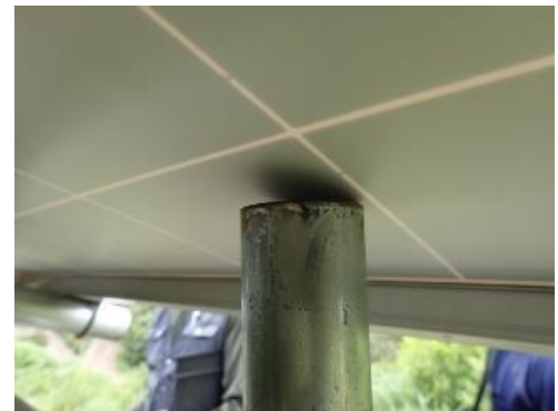
架台とモジュールの接近しすぎ
