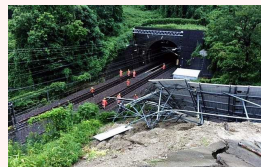
<太陽光パネルの崩落>
