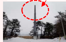
<風車の羽根の脱落>
