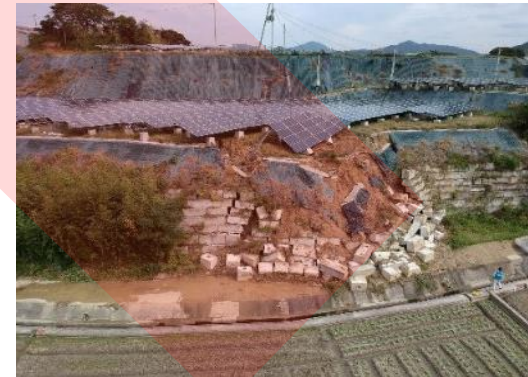
法面保護工が崩れて流出した事例
