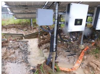
地盤侵食と排水溝の破損の例
