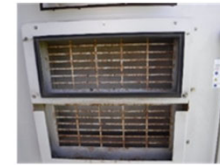
フィルタ部分の錆
