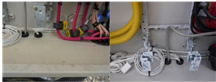
例：錆無し：176MΩ 錆有り：①0.356MΩ ②0.989MΩ
