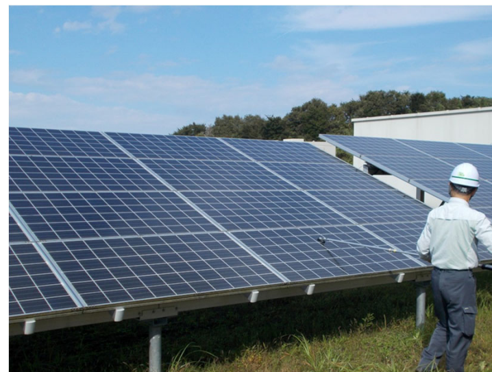
図 非接触電流測定によるストリング配線の確認方法の概要
