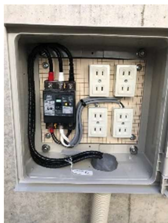
非常用コンセント
