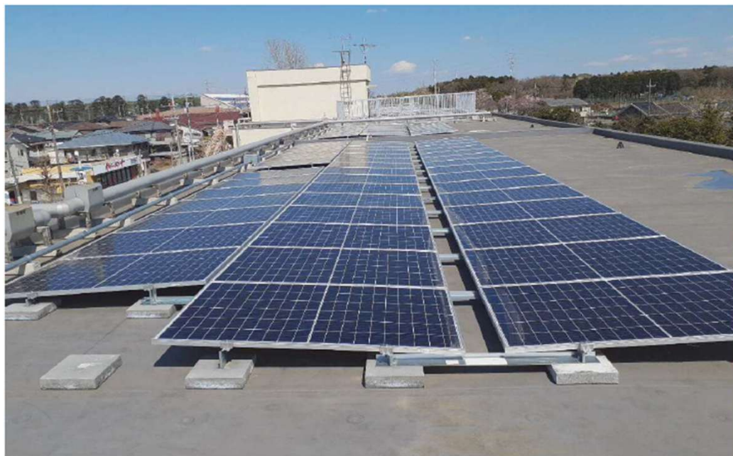
太陽光パネル
