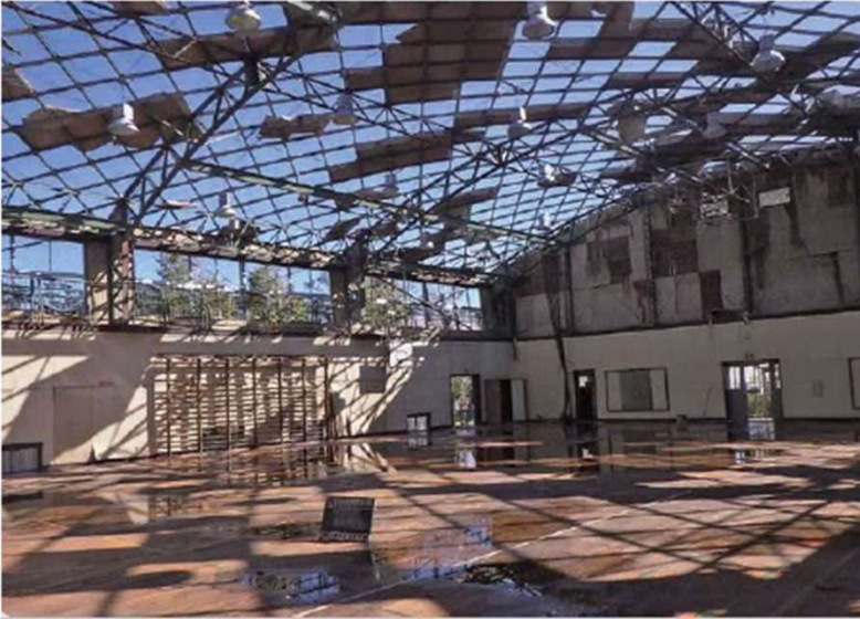
屋根が吹き飛んだ体育館
