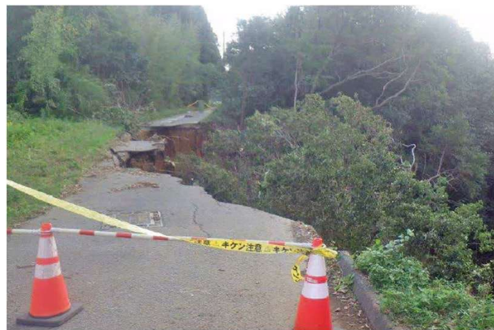
崖崩れにより分断された道路
