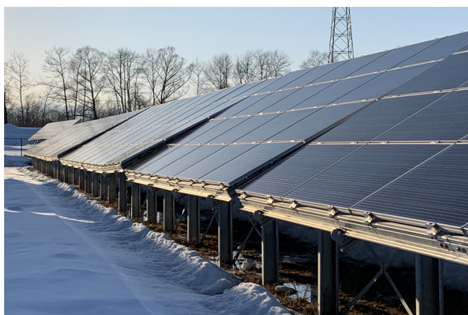
写真 1-1 太陽電池アレイ架台の凍上被害の一例
