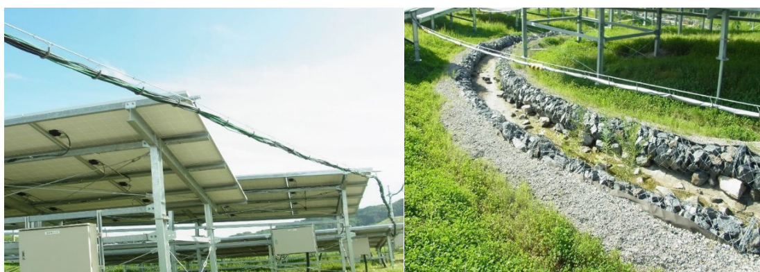
写真 13-2 架空配線の例
