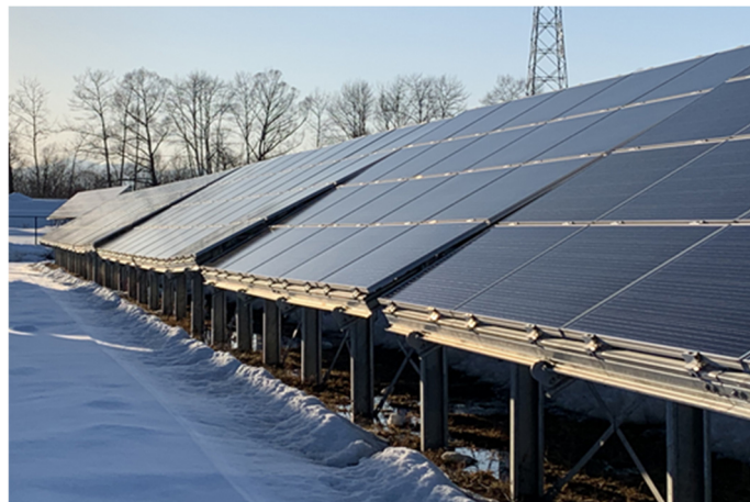
図 5-8 太陽光発電設備の凍上被害の一例
