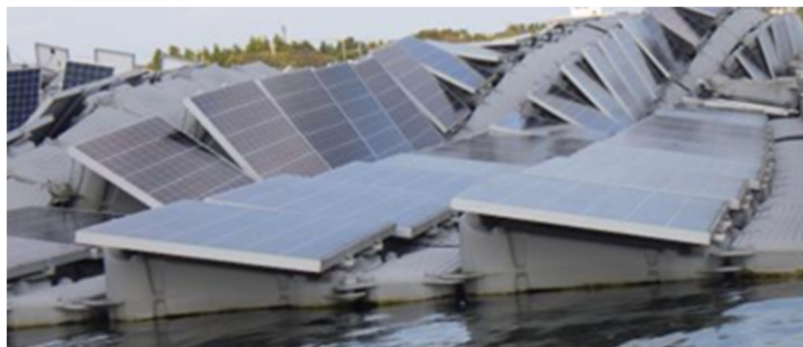
図 2-3 水上設置型太陽光発電設備の強風被害事例（3）
