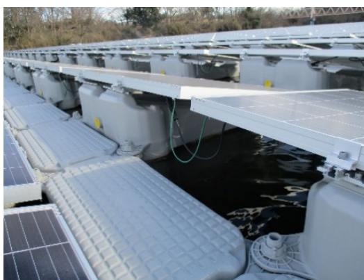
写真 12-1 余長を考慮した配線の例
