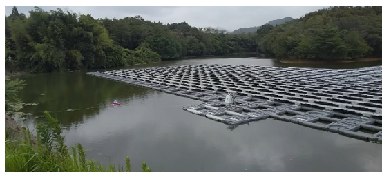
図 3-4 機器設置状況
