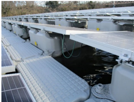
写真12-1 余長を考慮した配線の例
