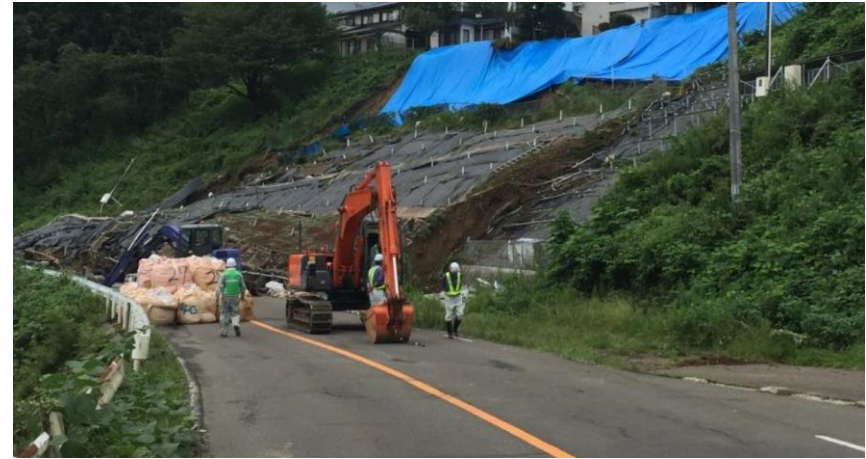
仙台市羽黒台の斜面崩落
