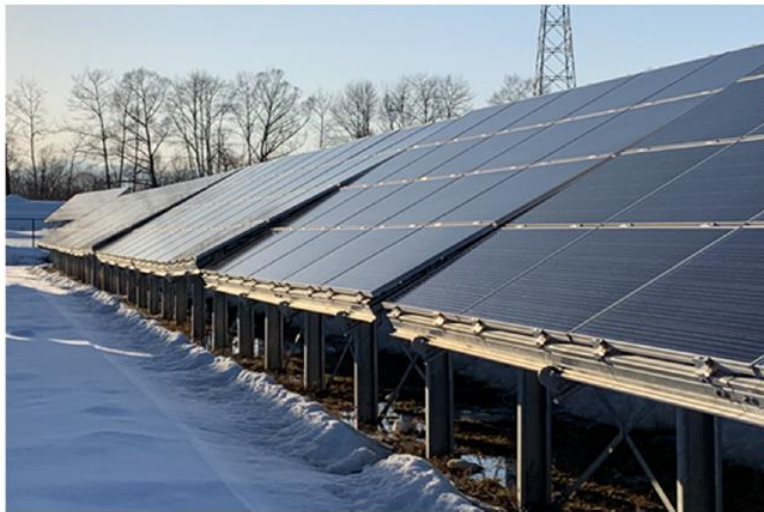
図 5-10 太陽光発電設備の凍上被害の一例
