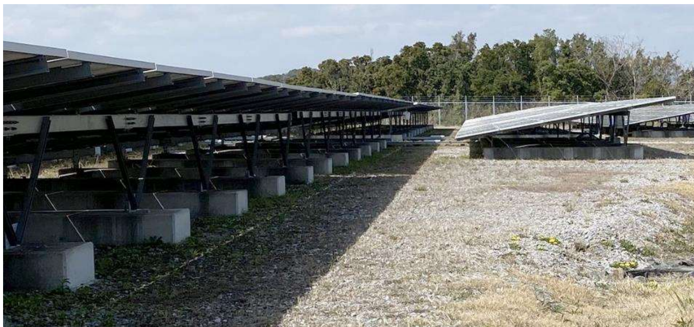
高圧発電所の例（台風上陸数の多い地域）
