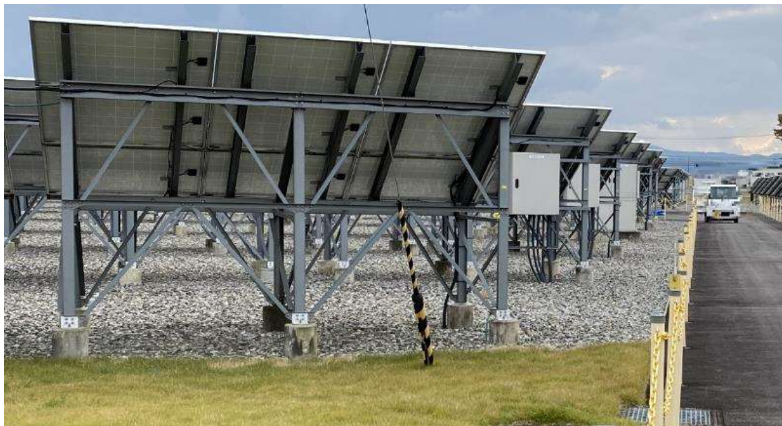
↑ 高圧発電所の例（多雪地域） チェーンは敷地内通路の仕切り
