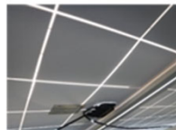
バックシート剥がれ C 補修、交換 地絡 ラミネーション不良と 推測される 押すとボコボコする
