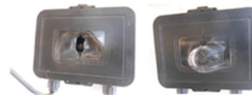
ジャンクションボックスで裂け、膨み C 補修、交換 地絡 火災
