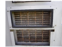
フィルタ部分の錆
