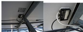
設置後 8 年で落下 端子箱内の充電部露出 バイパスダイオードがポッティングされて いない端子箱。
