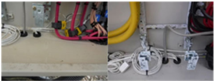
例：錆無し：176MΩ 錆有り：①0.356MΩ ②0.989MΩ
