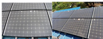
設置 10 年後全数剥離 設置 19 年後全数 剥離
