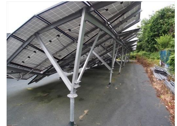
軒先荷重による被害
