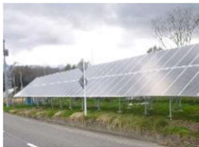
柵塀の設置されない設備
