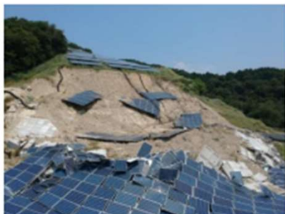
土砂崩れで生じた崩落
