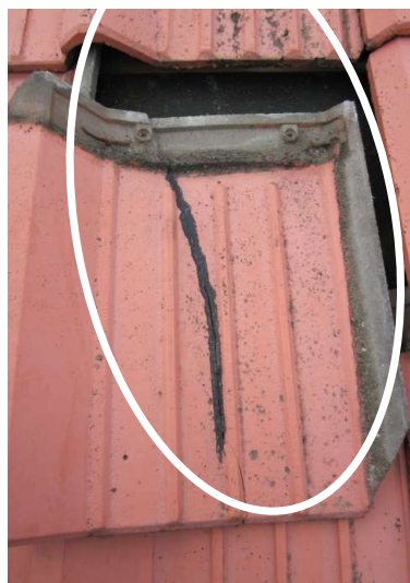
施工時の瓦破損箇所からの漏水
