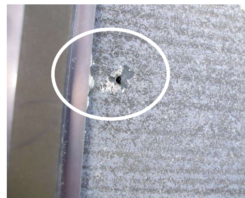
取付ビスの打ち間違いによる穴からの漏水
