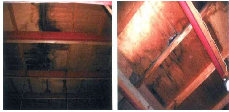
雨漏りの痕跡例
