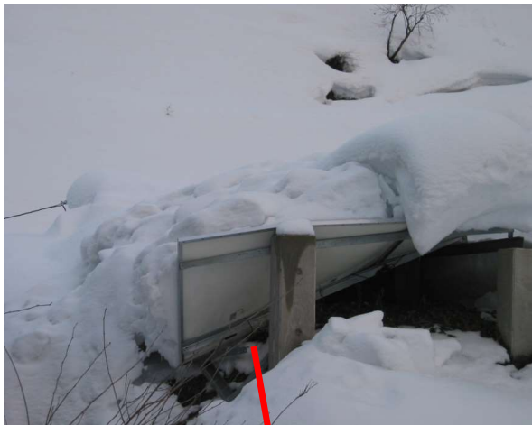
雪の重みで破損 点検で発覚
