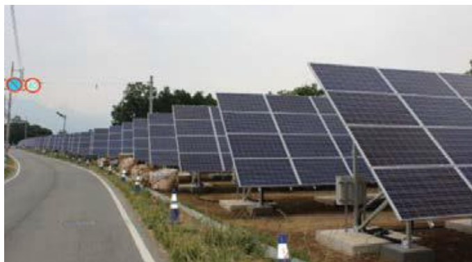
生活道路の間近に大規模 太陽光発電が設置
