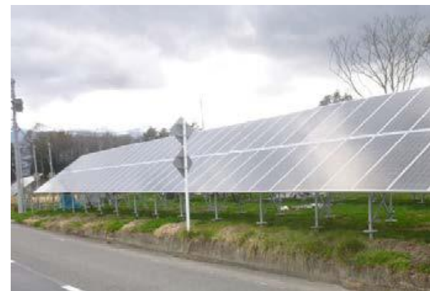
塀・柵が未設置
