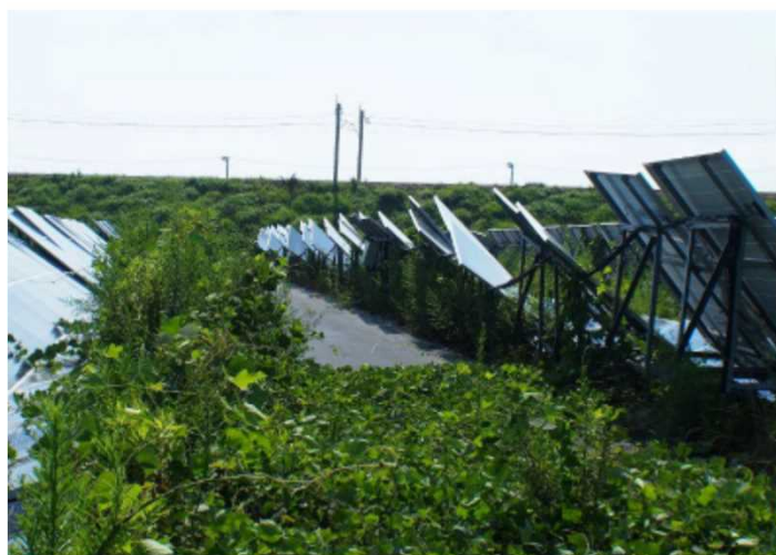
整備がされていない事例
