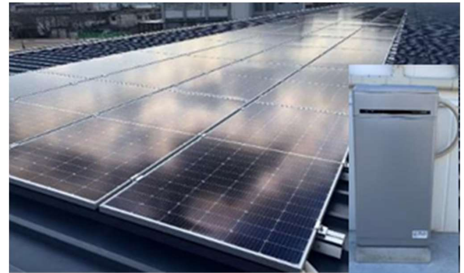
能勢町庁舎に設置されたオンサイトPPAによる太陽光発電+蓄電池
