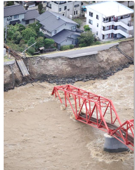
2019年台風19号 上田市内を走る別所線の鉄橋が崩落
