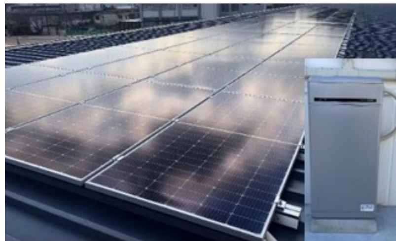
能勢町新庁舎に設置されたオンサイトPPAによる太陽光発電+蓄電池
