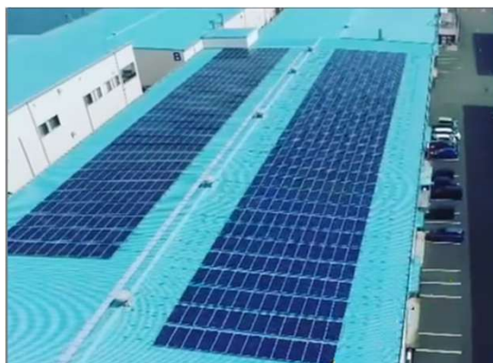
リユースパネルを用いた発電設備
