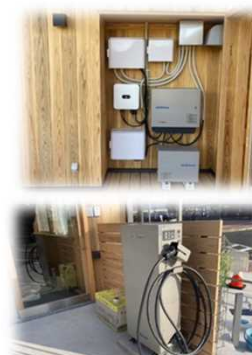
パワコン・蓄電池
