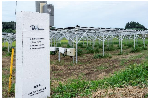
アパレルブランド「ロンハーマン」も市民エネルギーちばの理念の共感。オフサイト PPA でソーラーシェアリングの電気を使う。発電所をショップに見立てた看板がハイセンスだ。
