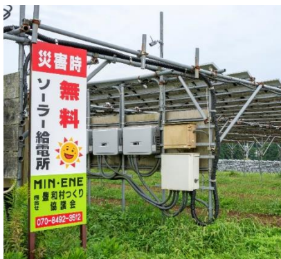
2014年に運用した1号機（匝瑳第一発電所）。甚大な被害をもたらした2019年の台風15号にも耐え、今も安定稼働が続いている。災害時には「無料ソーラー給電所」として地域の拠り所になる。
