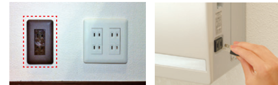
非常用コンセント (屋外設置パワーコンディショナの例) ※左側が非常用コンセントになります。 非常用コンセント (屋内設置パワーコンディショナの例)
