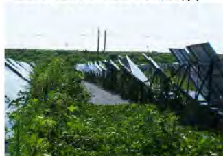
放置されたパネルの現況
