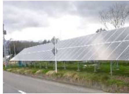
柵塀の設置されない設備
