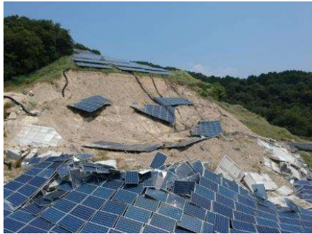
土砂崩れで生じた崩落
