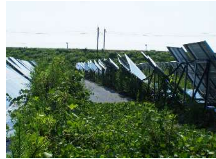
不十分な管理で放置されたパネル
