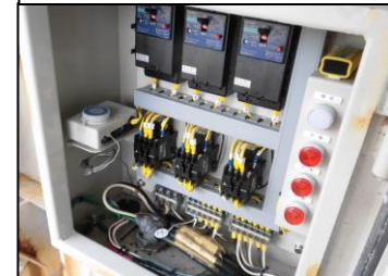
凍結防止制御盤内
