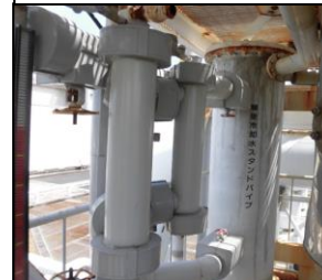
水位発信器検出配管
